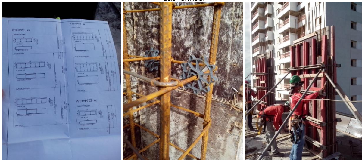
Figuras 9, 10 e 11 – Projeto das armaduras dos pilares; Conferência do espaçamento; Fechamento das formas.
